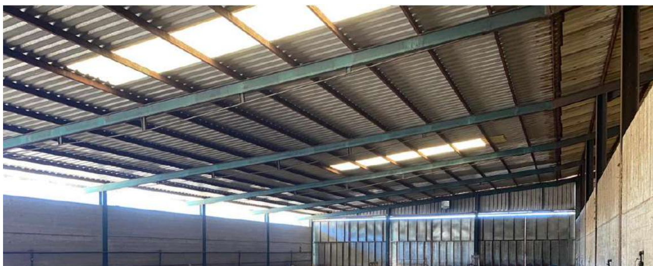
Figura 5: interior zona de secuestro 1
